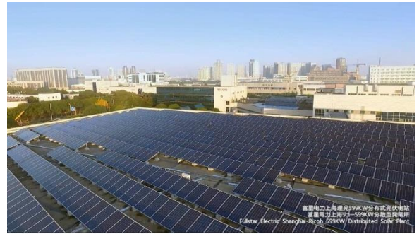
光伏发电项目
